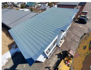
屋根の変色と劣化
