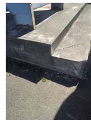
モルタル割れ
