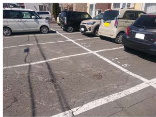
駐車場のひび割れ
